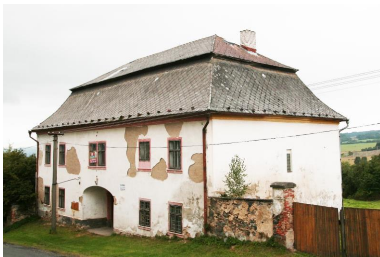
Obrázek 11 Fara Čížkov na prodej, výrazně poškozená statika objektu; soukromý archiv autorky
