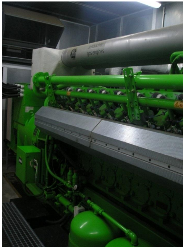
Obr. 14 - Kogenerační motorgenerátor Jenbacher o výkonu 1,1 MW
